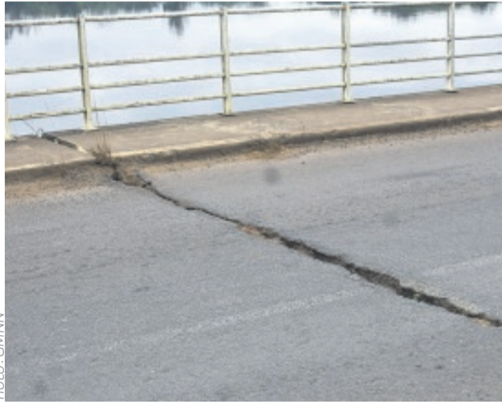
La fissure qui fait peur aux voyageurs sur le pont de Kango.
